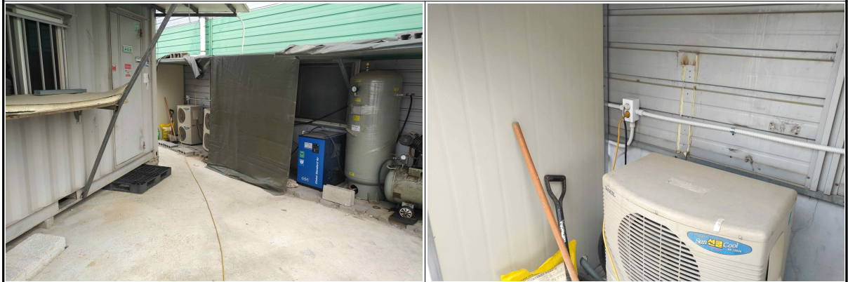
전원 연결부분 사진
